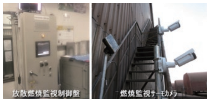
図12: 監視装置の設置状況
