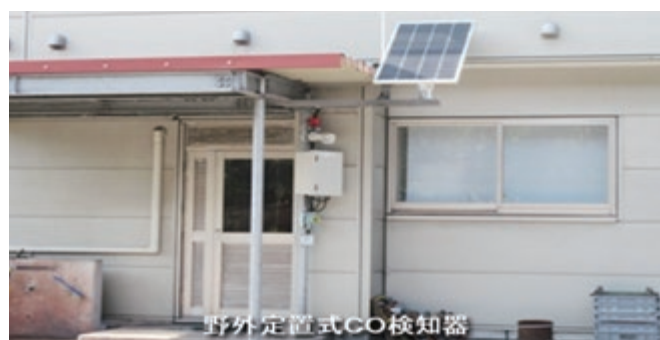
図11：野外無線式CO検知器の設置状況
