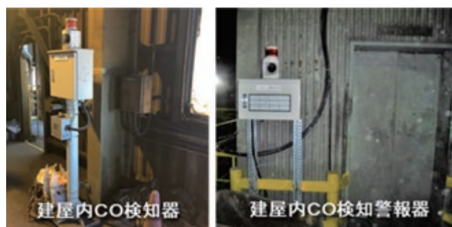
図10：建屋内検知器および警報器の設置状況
