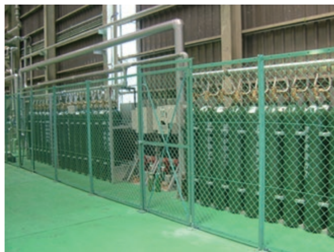
図8：CO 2 消火設備（高圧）
