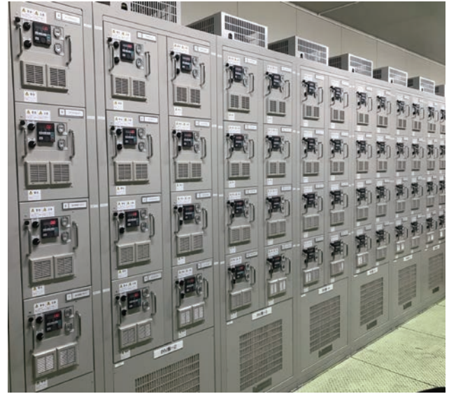
<図10:段積みインバータ盤写真>
