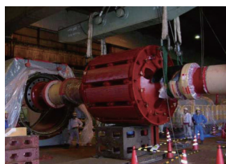
大型 回転子挿入(12,000KW)
