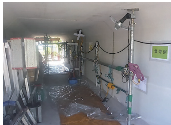
図3: 模擬洞道・マンホール
